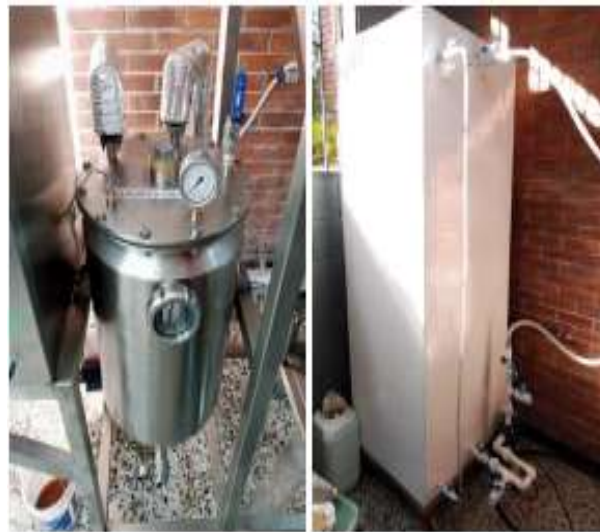
Anexo B. Calentador de aceite y tanque con bomba de agua.
